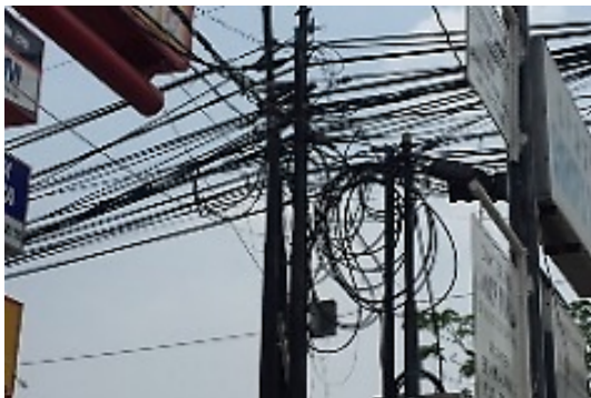
Gambar 12. Kabel listrik di Kota Tangerang
